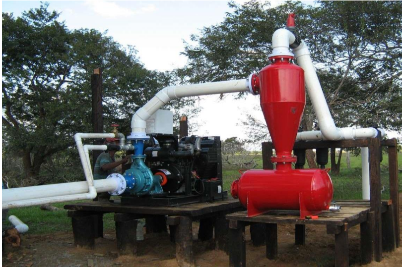
Fig 1. Motobomba e hidrociclón sobre pedestal, en zona inundable.
