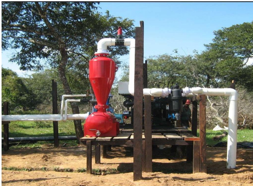
Fig 2. Hidrociclón y filtros de malla montados sobre pedestal.
